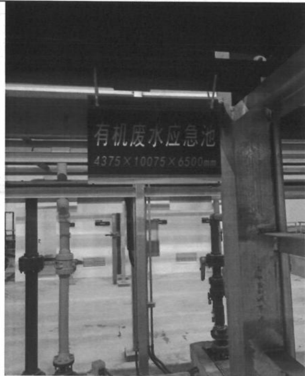
废水站事故应急池 250m 3
