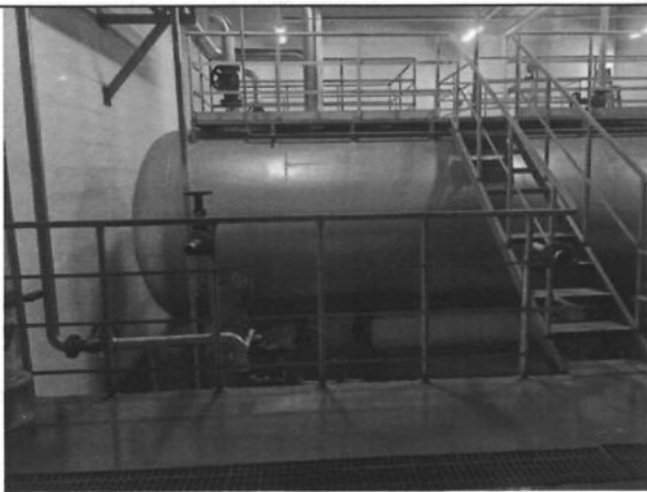
导热油锅炉油罐区
