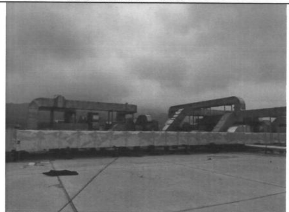
负极 NMP 废气处理系统
