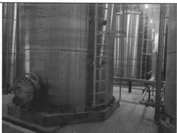
NMP 原液、废液罐区
