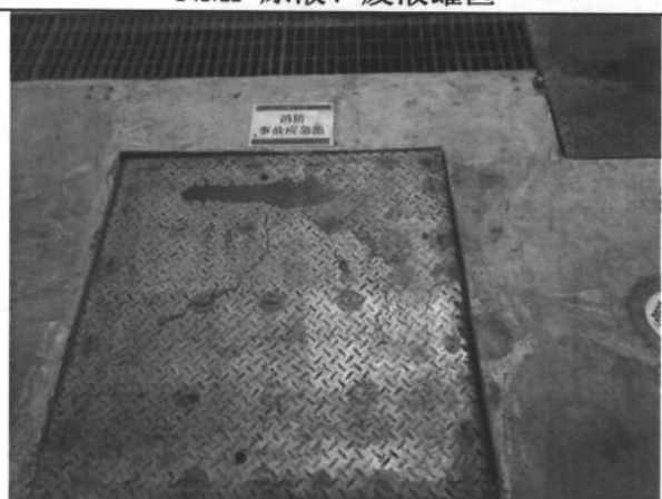
S1 消防事故应急池 1000m 3
