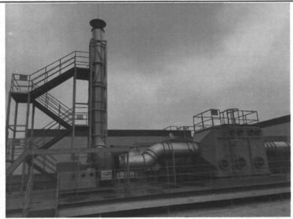
二次注液废气处理系统
